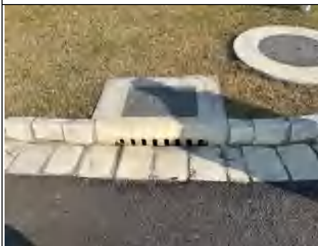
厂区排水管网（2023年12月）
