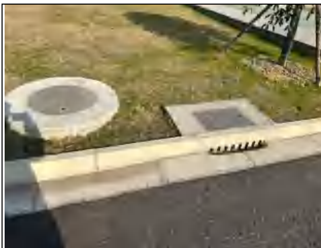
厂区排水管网（2023年11月）
